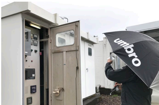
SGSジャパン株式会社による西都工場の電力メーターの確認
